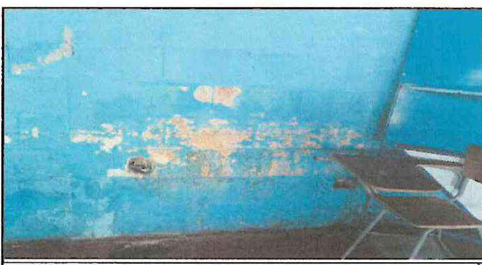
Falta pintura adentro de los salones
