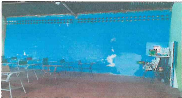
Salón No. 3: pared mojada en un 98%
