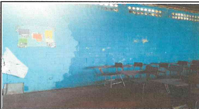
Salón No. 1 pared mojada en un 90%
