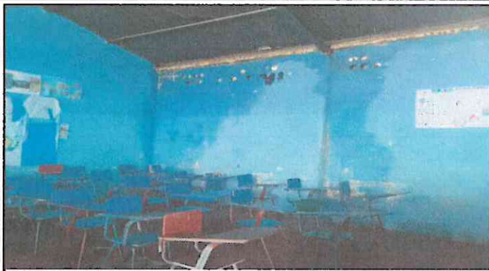
Salón No. 2. pared mojada en un 85 %
